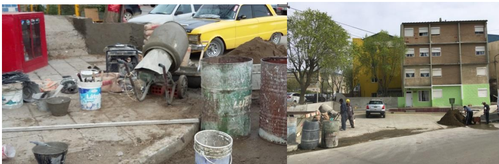
No se ve obrador, ni baños químicos. Tampoco se observa de lugar para acopio de materiales.
