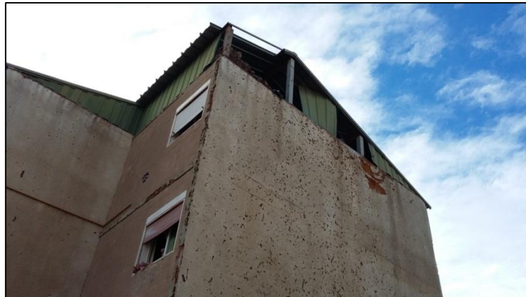
Fotografía n° 7: Patologías en medianeras.
